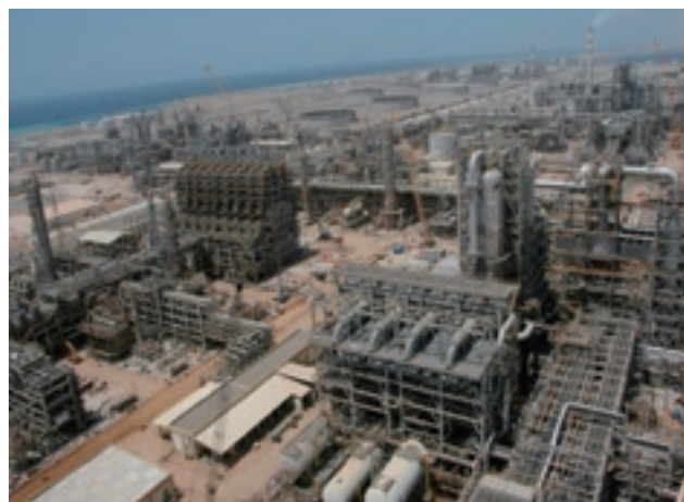
ラービク石油精製・石化プロジェクト
